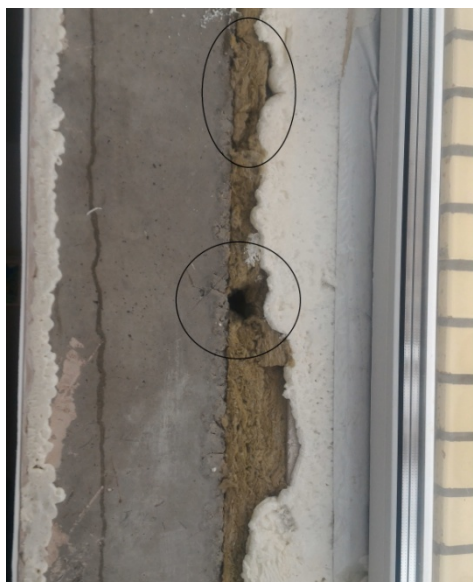
Рис. 2. Фрагмент выдувания слоя утеплителя многослойной ограждающей конструкции
