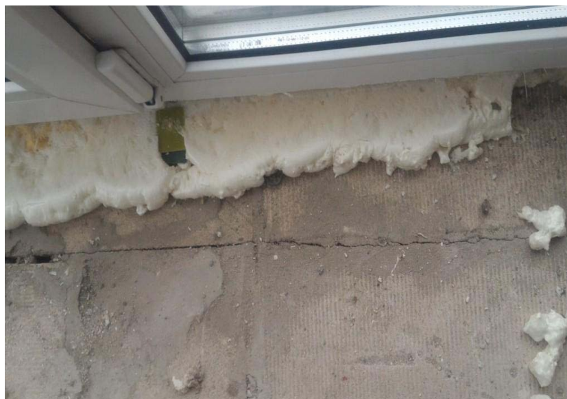
Рис. 3. Фрагмент продувания через трещины вертикальных швов двурядной газобетонной кладки
